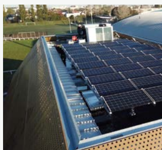
Amandiers. Idrettsanlegg. Carrierre sur Seine, Frankrike. ECOi-W.
